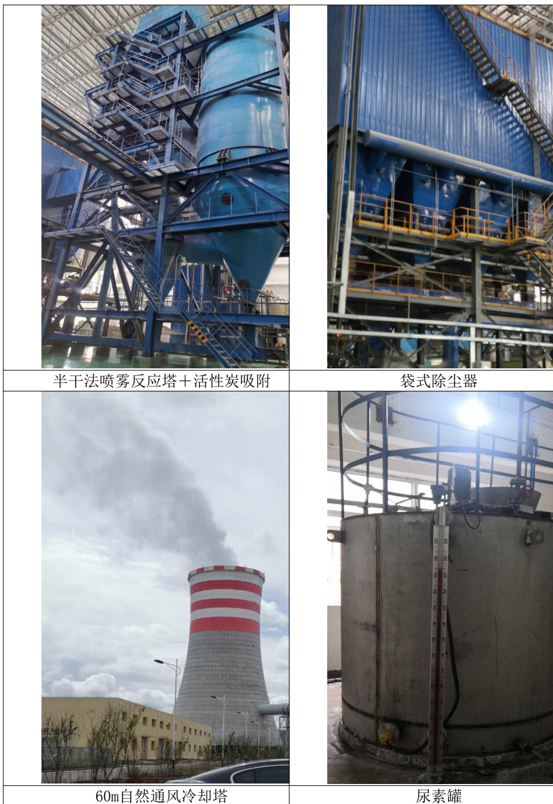
图3. 3-1 焚烧烟气处理设施
