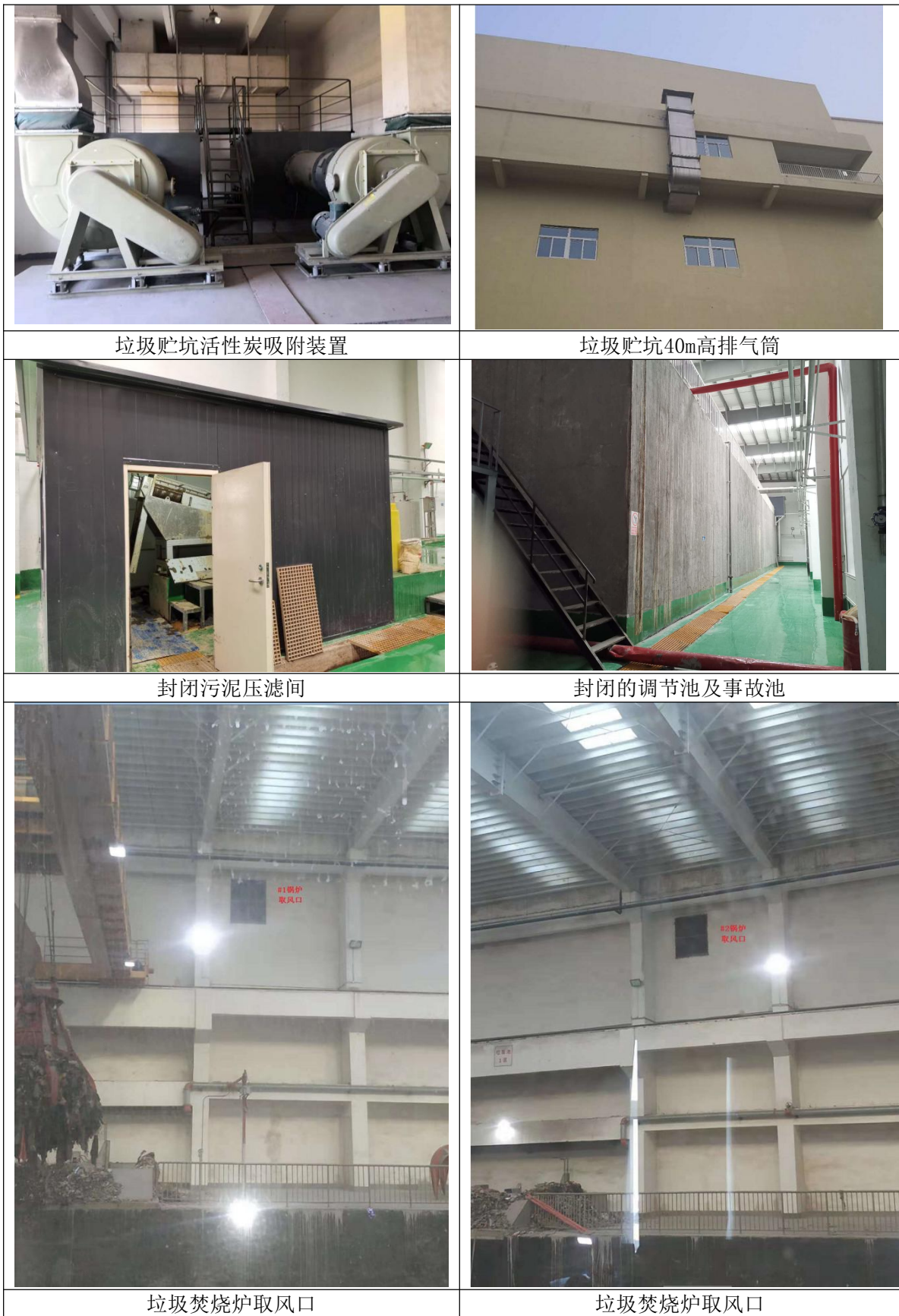
图3. 3-3 恶臭处理设施
