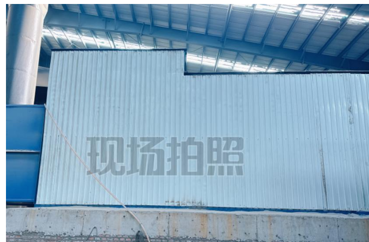
现有热风炉多管除尘器
